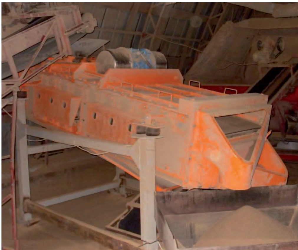
Грохот двухдечный ULS 2.8x1/2 в линии тонкого просеивания сухого кварцевого песка. Год запуска в эксплуатацию – 2008.
